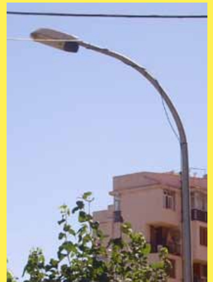
Detall d'un punt de la xarxa pendent de millora
